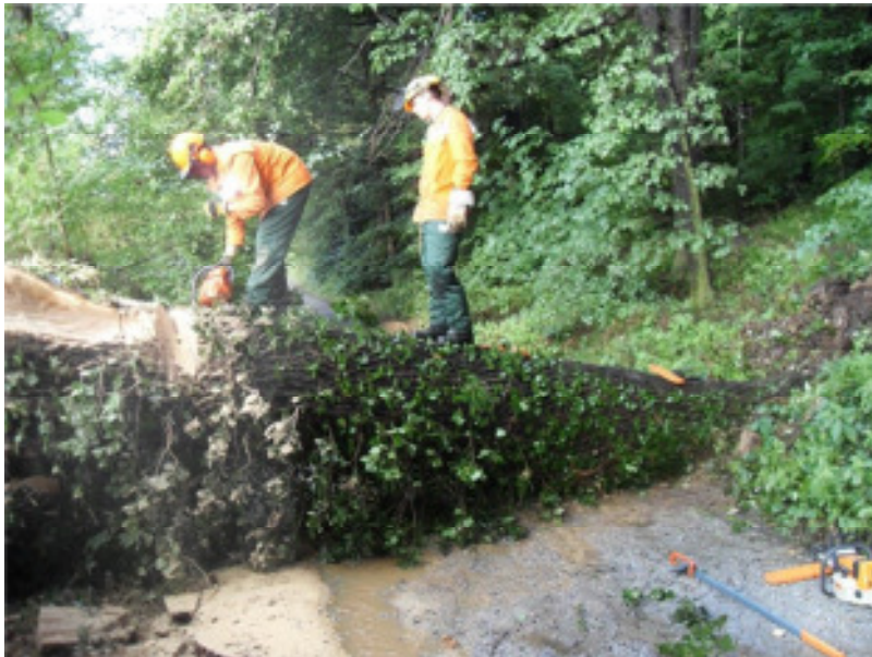
Abb. 31. Umgestürzter Baum nach Sturmereignis, Einsatz der Feuerwehr Worms, © Stadt Worms
