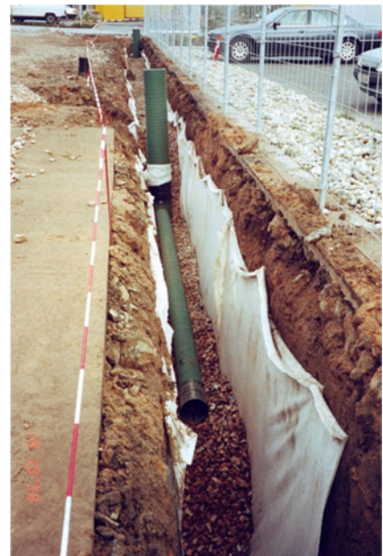
Abb. 29. Rigolenversickerung von Niederschlagswasser in einem Wormser Gewerbegebiet, © Stadt Worms.
