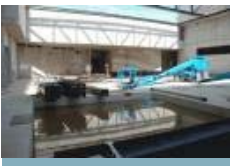
Rohbau des Saals im Neubau. Aus den Vertiefungen (derzeit mit Regenwasser gefüllt) können später einmal die Bühnen herausgefahren werden
